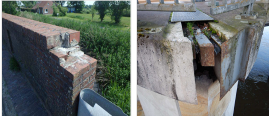
Abbildung 16: Schadhafte Mauerwerk und fehlendes Abdeckblech an Übergangskonstruktion (Quelle: LRH)
