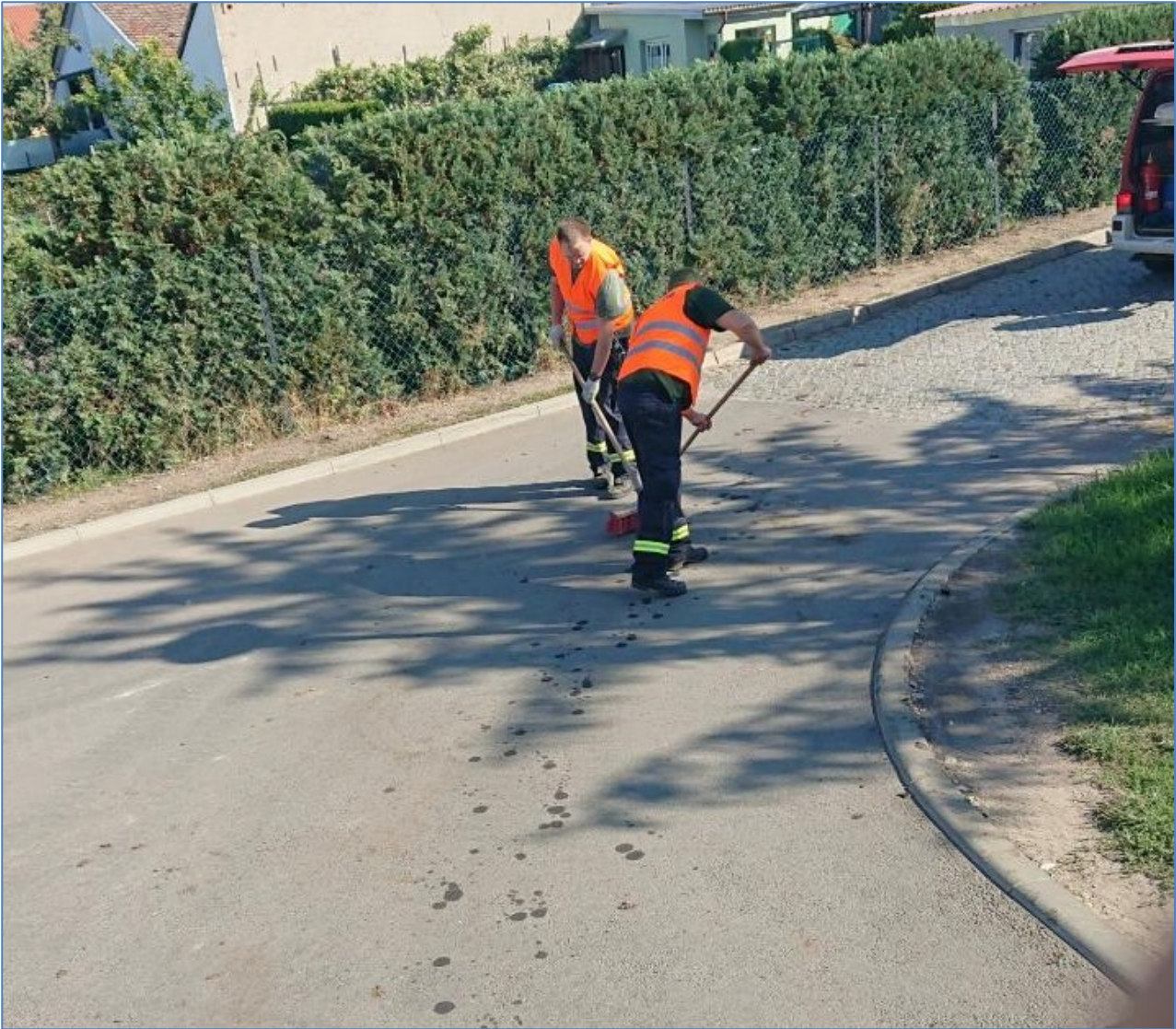
Abb. 14: Einsatz der Feuerwehr Großneuhausen am 03.09.2022 bei der Beseitigung einer Ölspur 3
