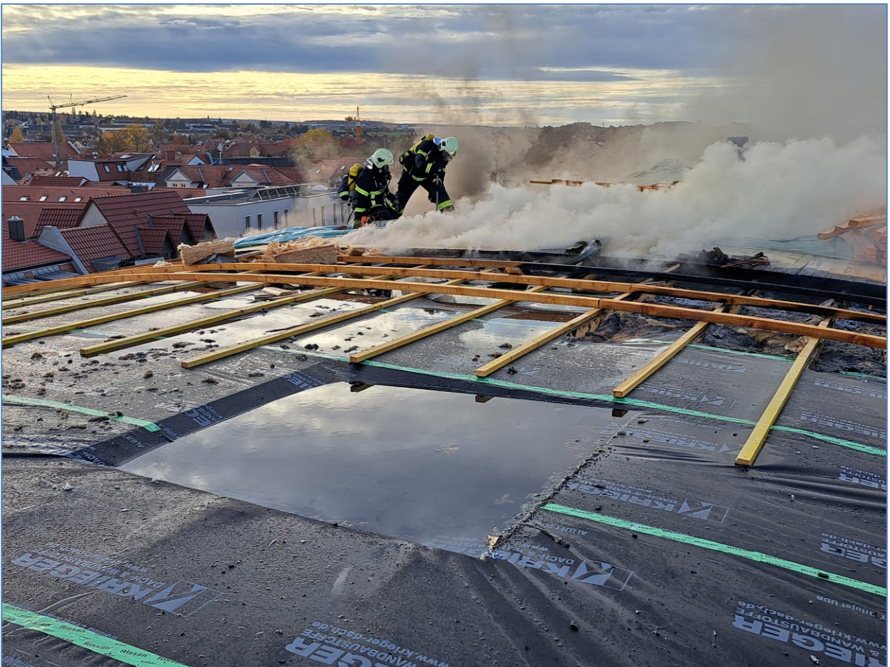
Abb. 10: Einsatzkräfte der Feuerwehr Weimar am 15.11.2022 bei einem Dachstuhlbrand im TLVwA 1
